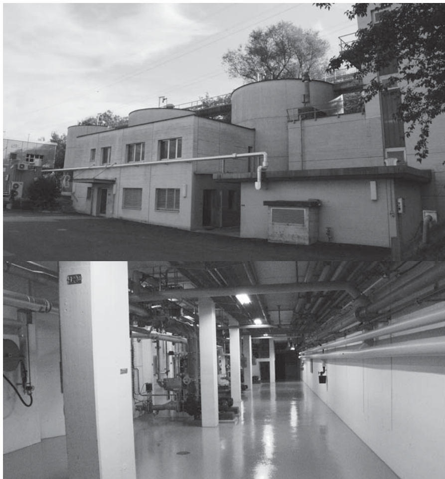
Verschiedene Anlageteile haben ein Alter erreicht, wo Ersatz- und Modernisierungsmassnahmen umgänglich werden.
