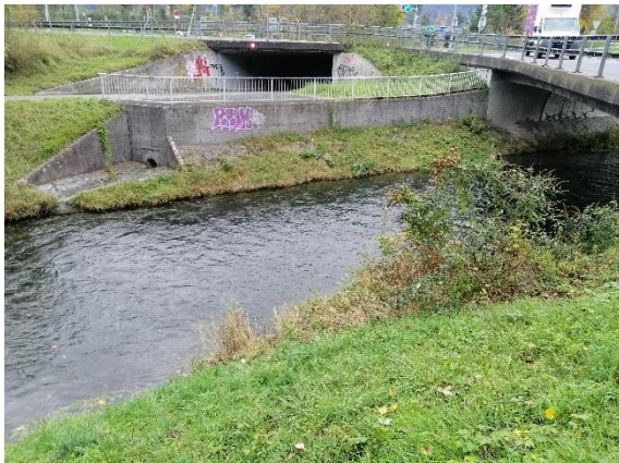
Abbildung 5: Uferverbauung der ersten 20 m nördlich der Brücke Langäulistrasse, Blickrichtung zum östlichen Ufer des WBK, 28.10.2022
