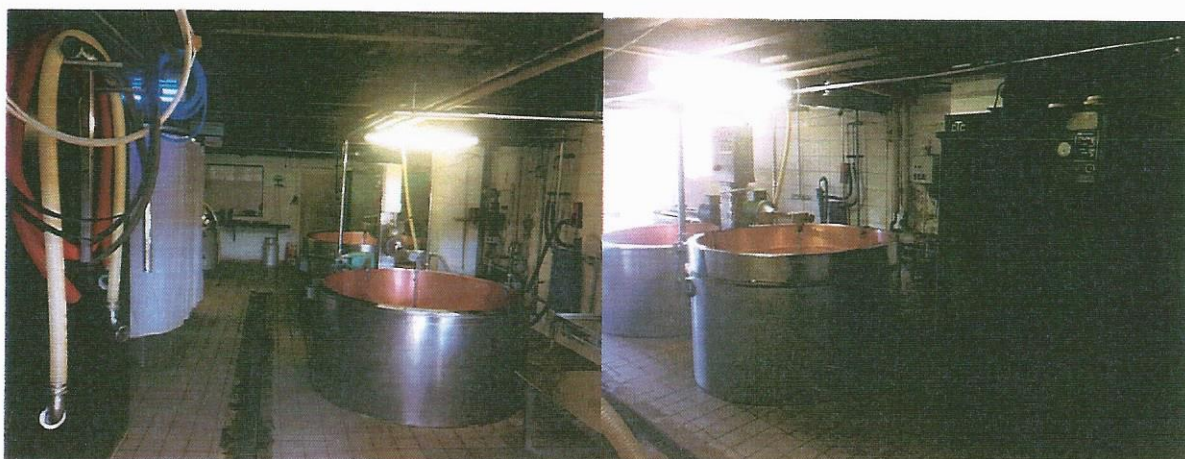
Fromagerie et chaudière
