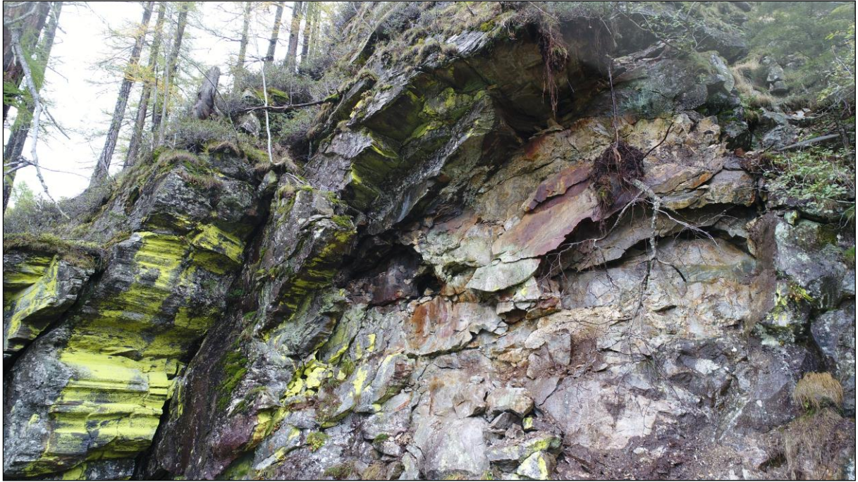
Foto 3: Parte alta della zona di stacco, uno spurgo della roccia si rende necessario.
