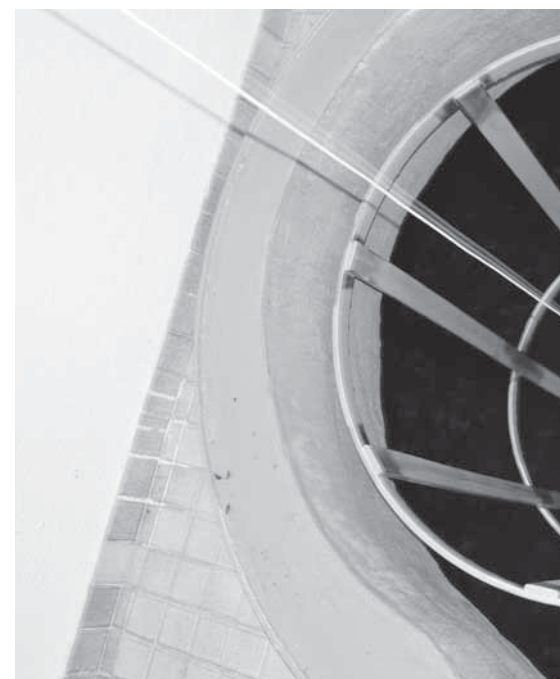
Wasserentnahme im Kraftwerk Tobeläckerli
