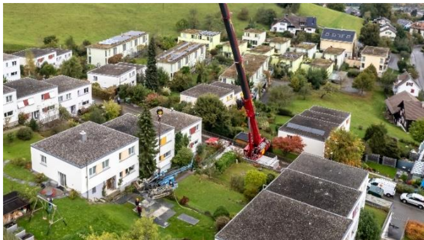
Legende: Nachhaltige Wärmeversorgung durch Inauen Heizung: selbst in Wohnsituationen ohne direkten Zufahrtsweg
