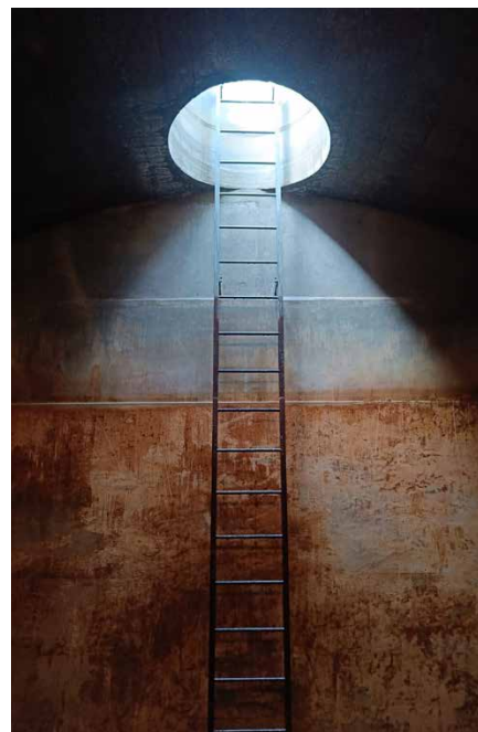
Blick in den Untergrund der Wasserversorgung Dinhard.
