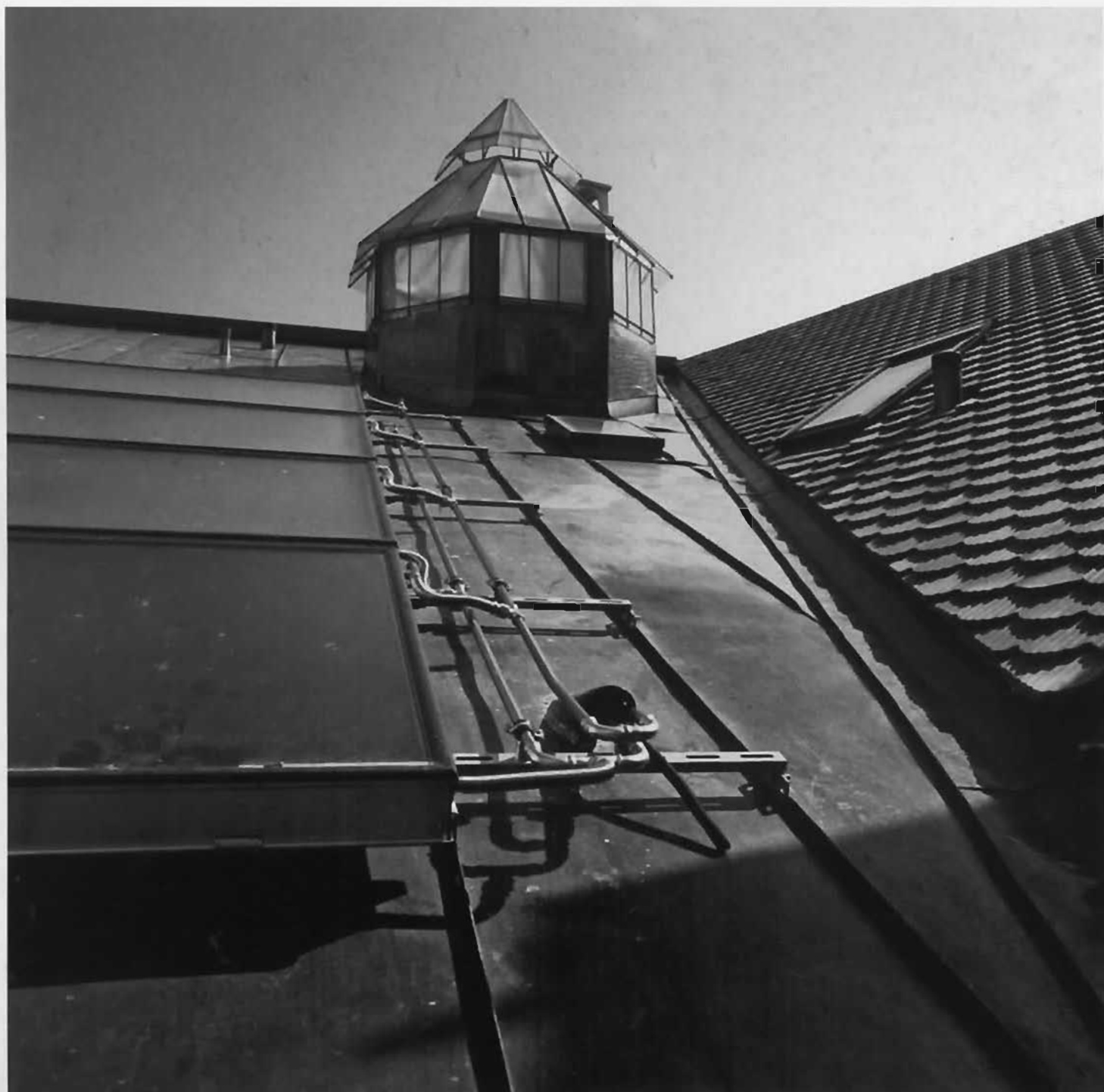
Installation solaire en toiture
