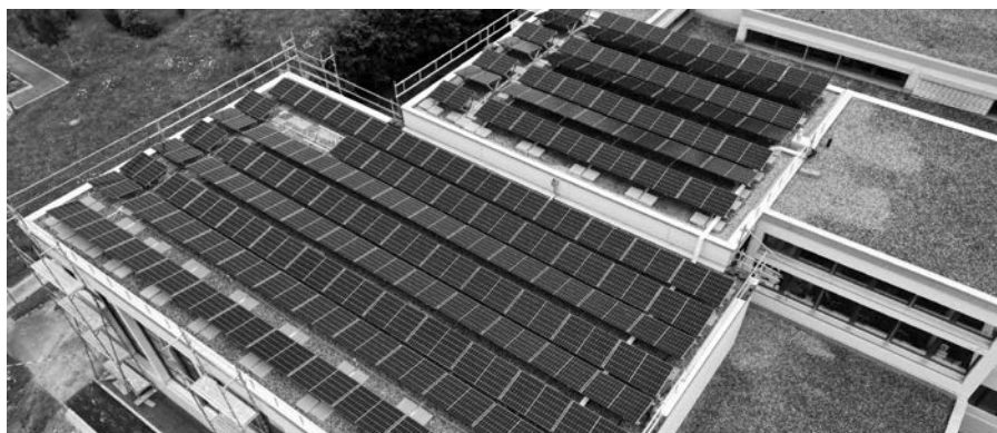
Neue PV-Anlage Bifang
