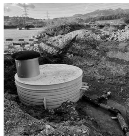
Neuer Verbindungsschacht Schmerikon
