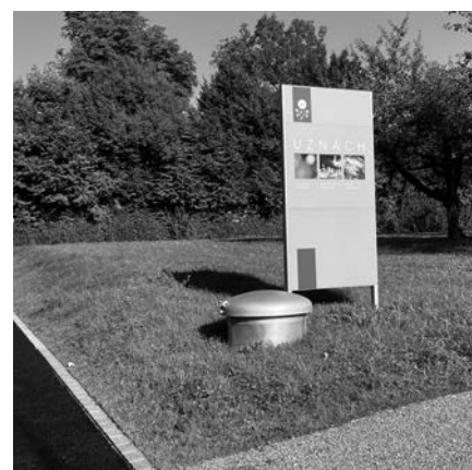
Neuer Verbindungsschacht Kaltbrunn
