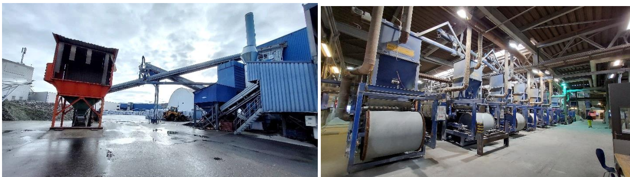
Abbildung 6: Aufgabetrichter Trockner und Produktion, Produktionshalle mit Heizöfen
