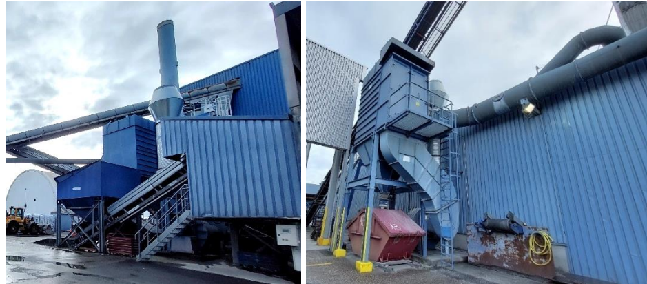
Abbildung 17: Foto bestehende Absauganlage Rohglas und Abfüll- station
