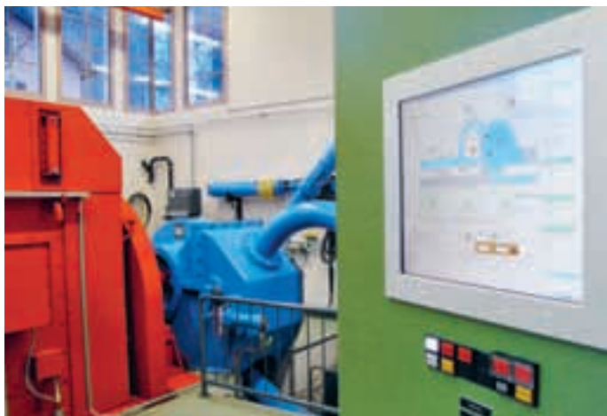
Die erneuerte Technik im Kraftwerk Altendorf.
