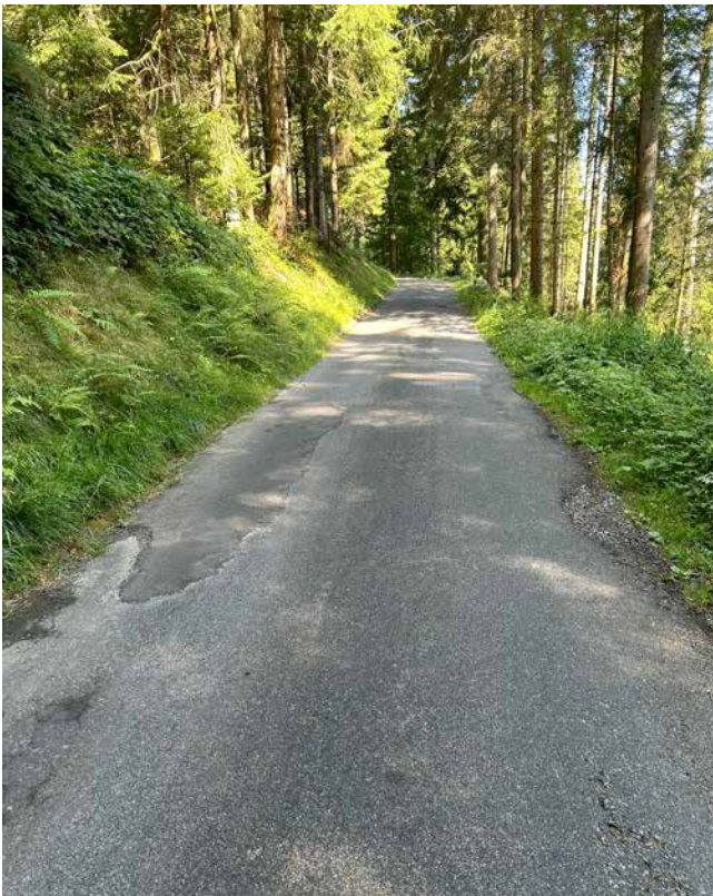
Belagsschäden im Bereich Hintermangeli
