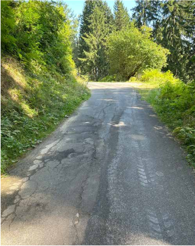
Belagsschäden im Bereich Vordermangeli
