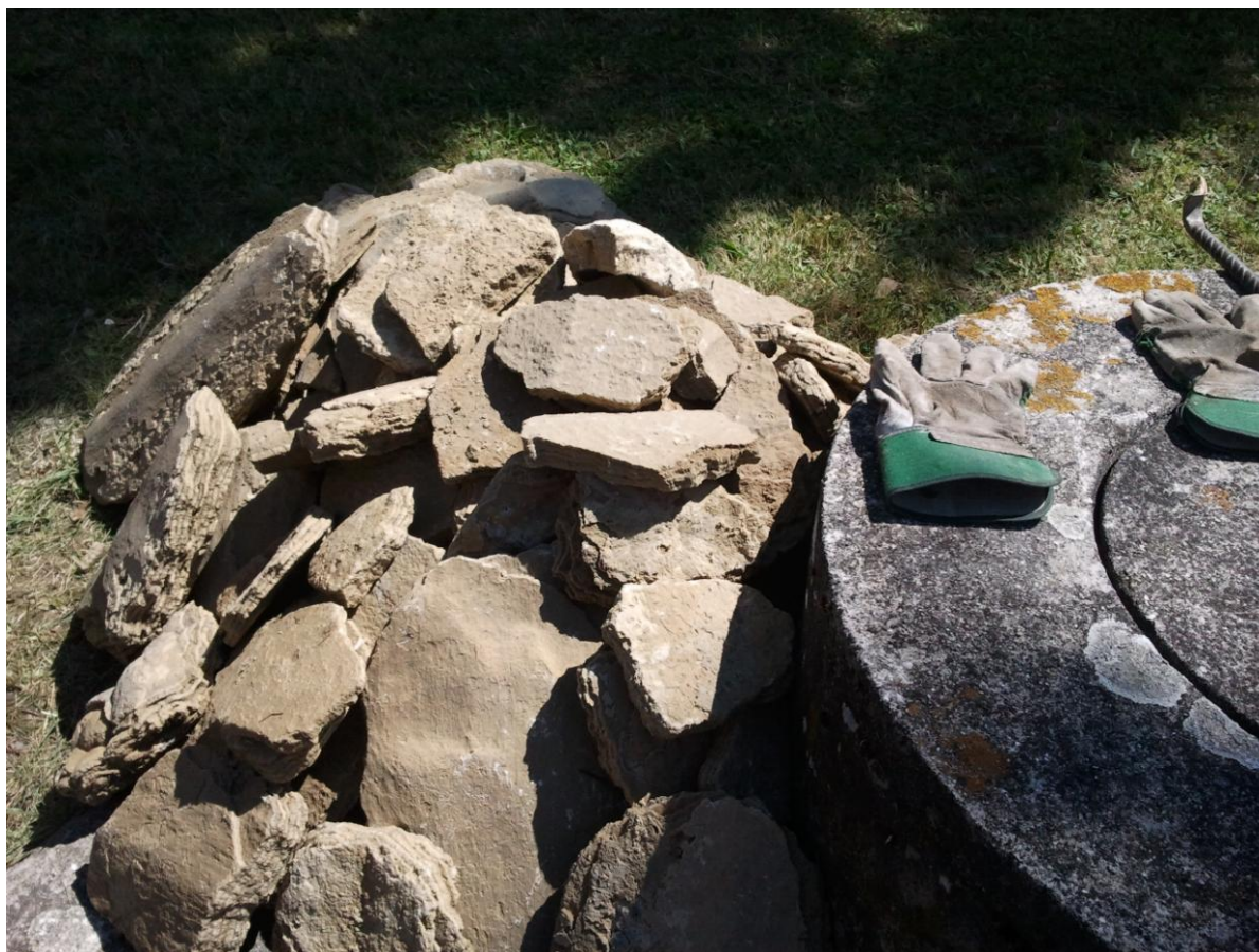
Petite partie du calcaire retiré du collecteur en béton
