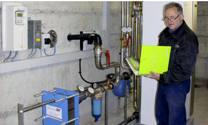
Das Herzstück der Anlage mit Wärmetauscher und ganz viel Technik.
