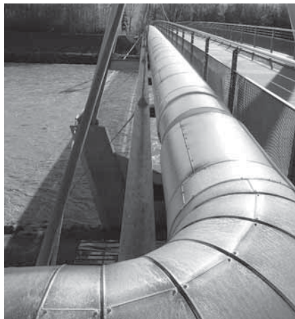
Über diese Leitung liefert der VfA Prozessdampf nach Liechtenstein.
