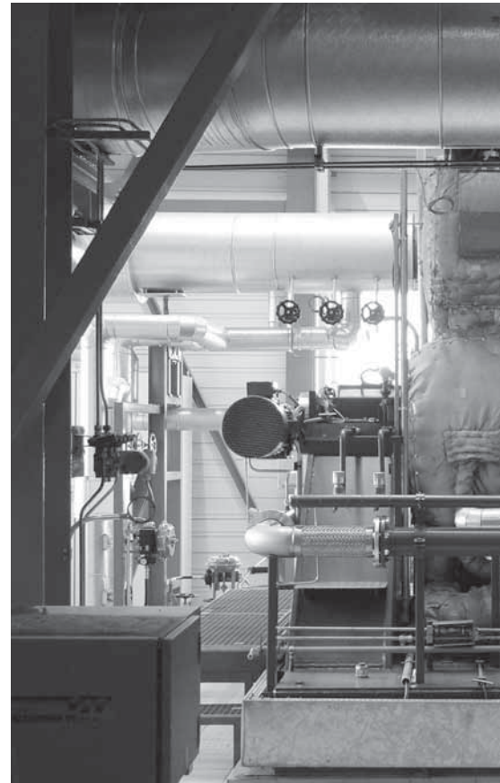
Turbine und Generator, die rund um die Uhr Strom produzieren.
