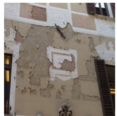
Abbildung 3: Ungeeignete Fassadeninstandstellung, falscher Farbanstrich bzw. Putz (Bellinzona).
