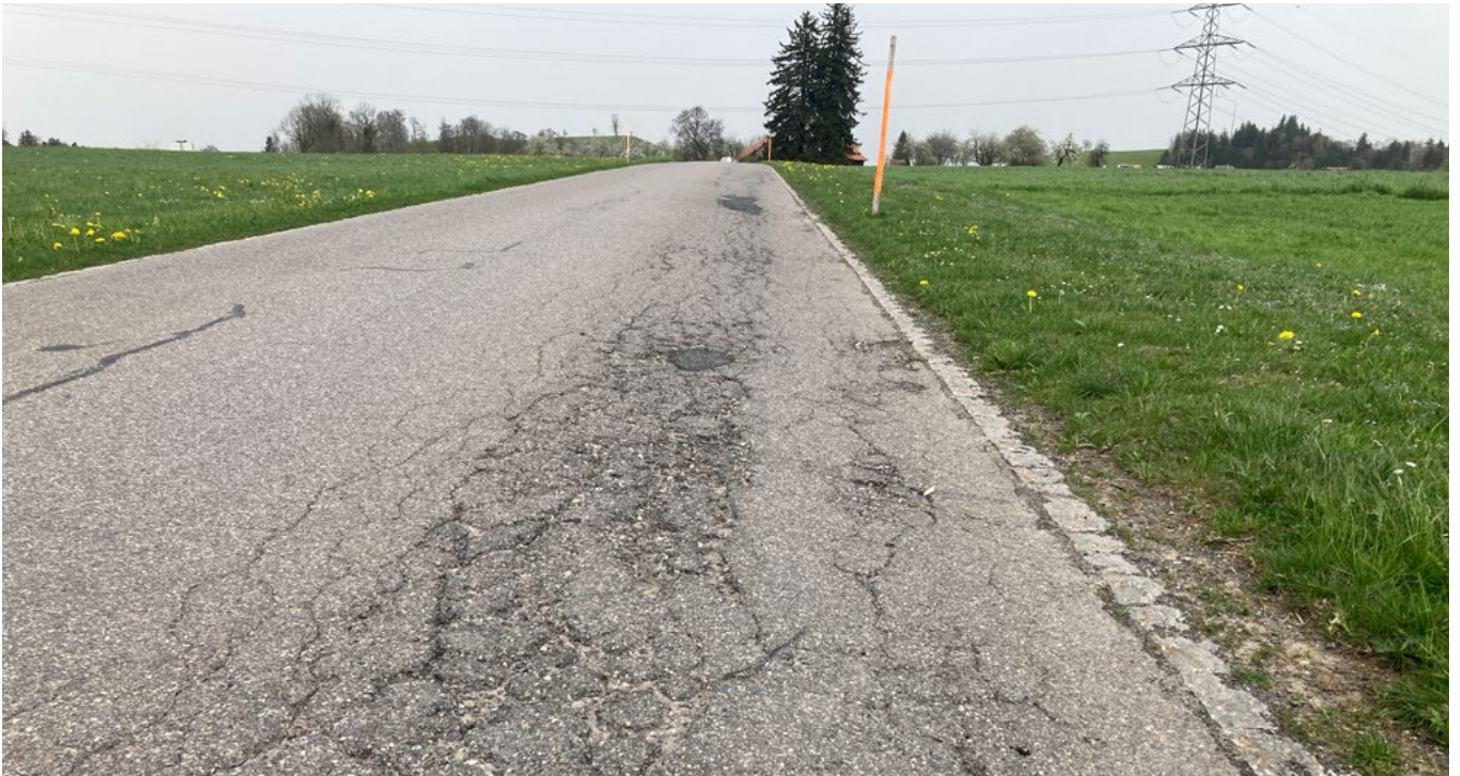
Schlaglöcher im Bereich Schurtannen Richtung Stockacher
