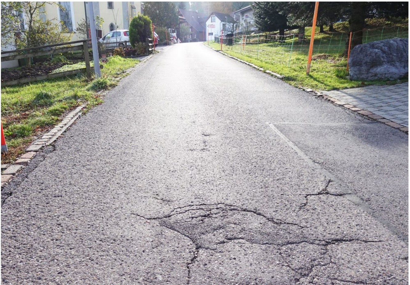
Belagsschäden im Bereich Zufahrt Fichtenhalde 18
