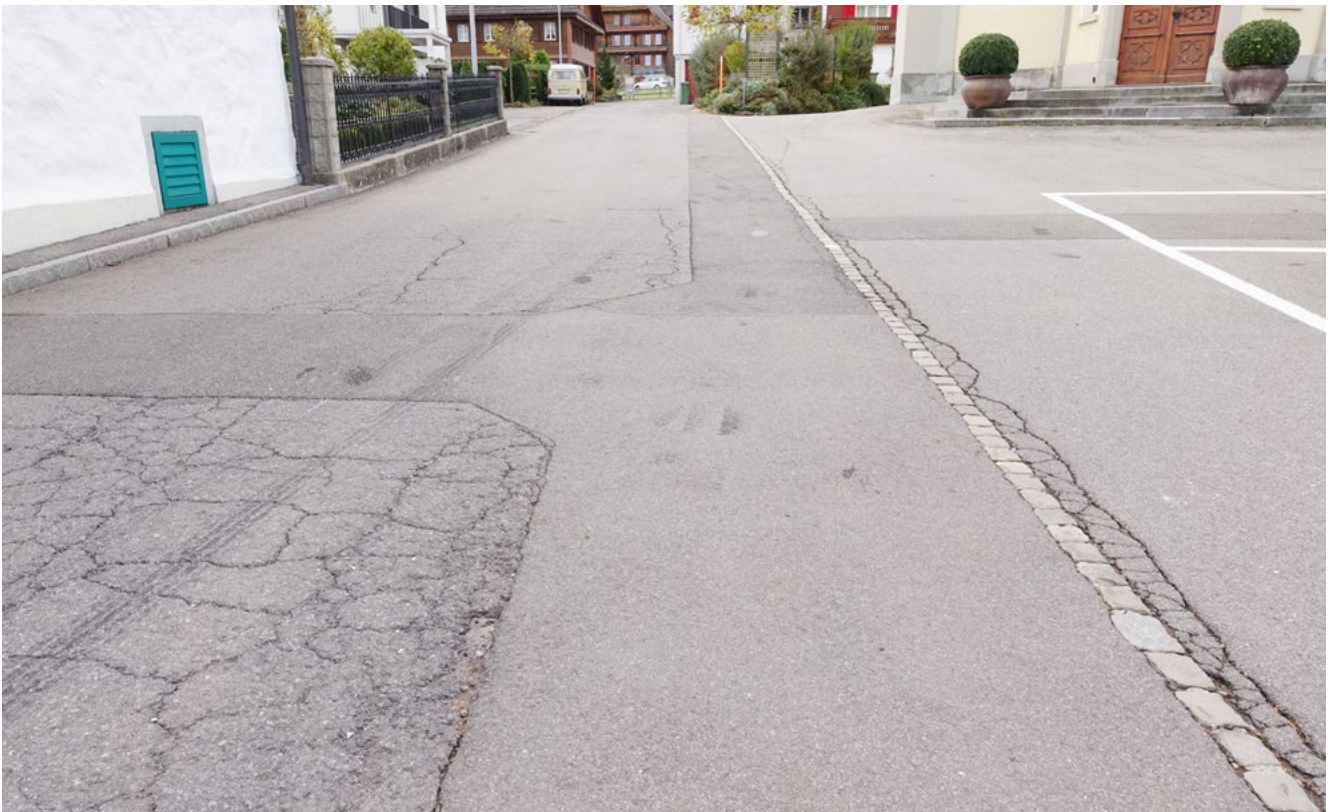
Belagsschäden im Bereich Bushaltestelle Kirche
