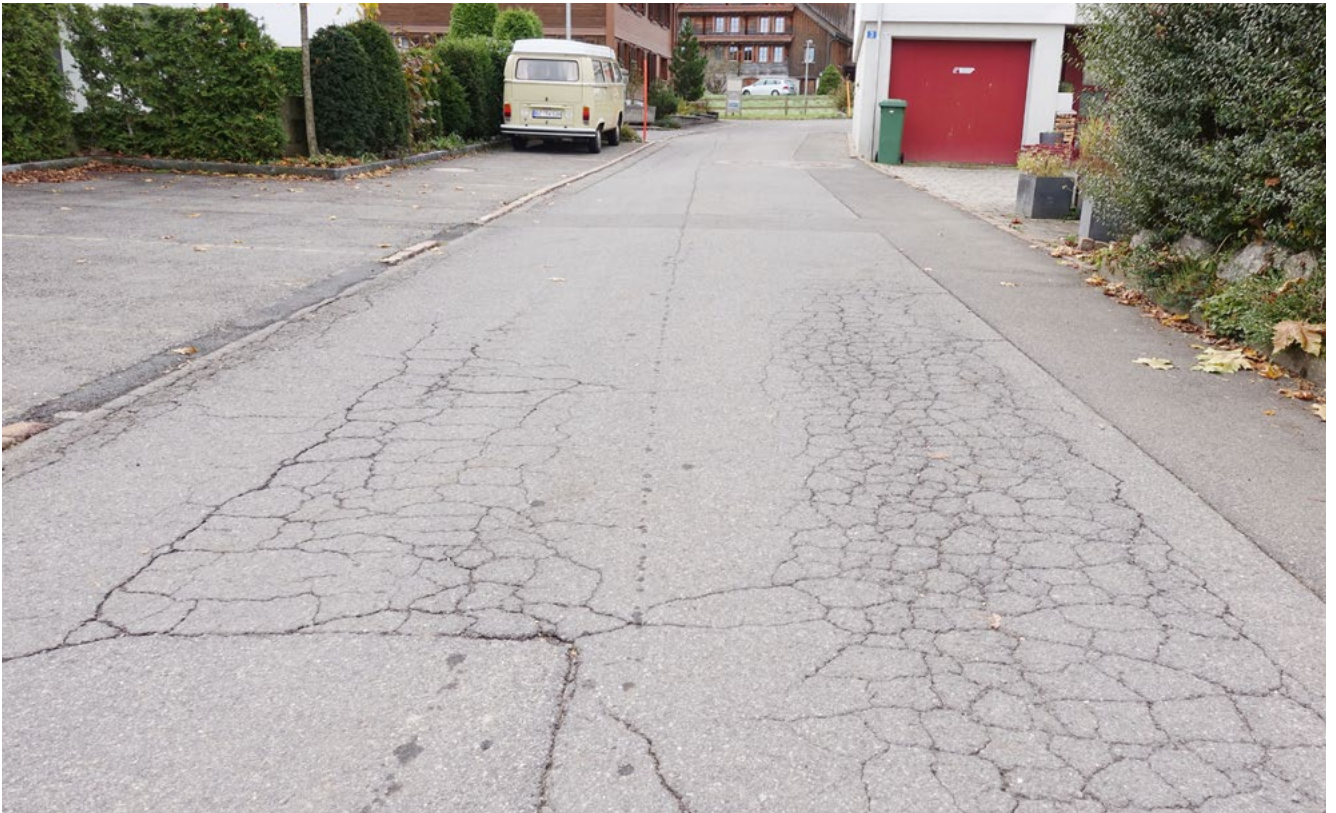
Belagsschäden im Bereich Im Dörfli 4
