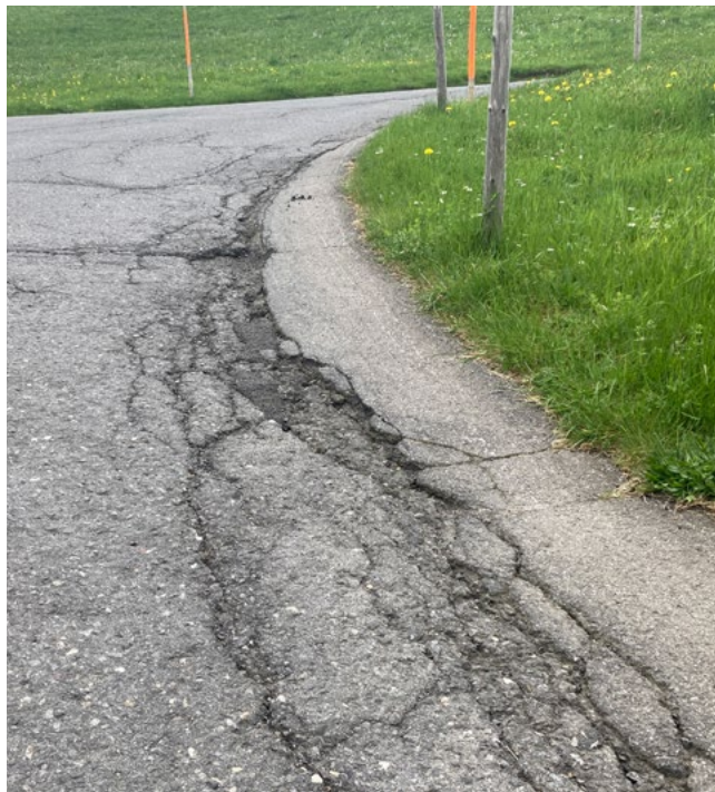
Belagsschäden im Bereich Bachmüli
