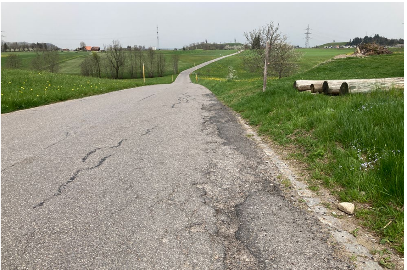
Belagsschäden im Bereich Schurtannen in Richtung Stockacher
