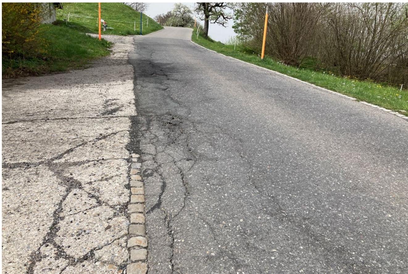
Belagsschäden im Bereich Hasental
