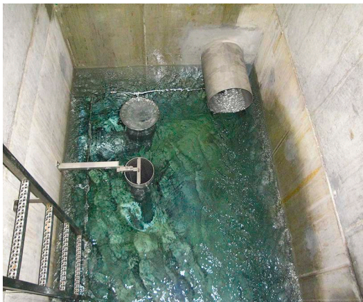
Pumpwerk Stolzenmühlequelle. Foto: Daniel Gerber.
