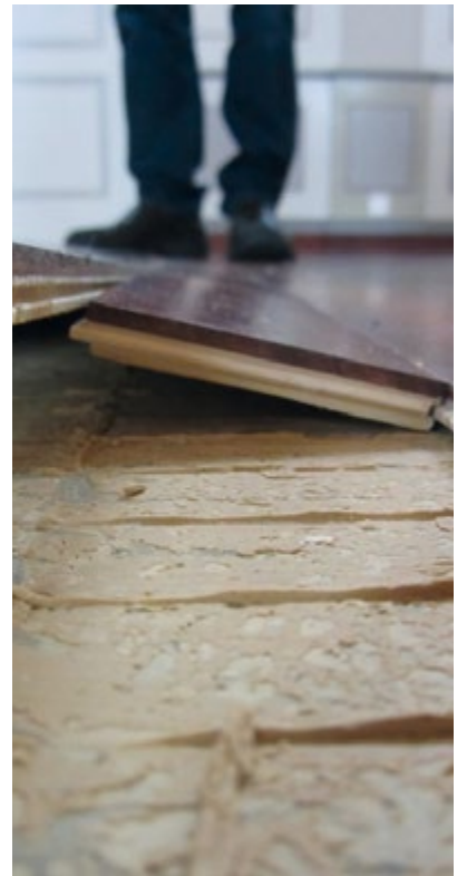
Der Unterlagsboden ist vom Schadenereignis nicht betroffen.
