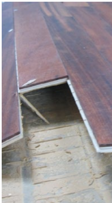
Der gesamte Parkettboden muss ersetzt werden.
