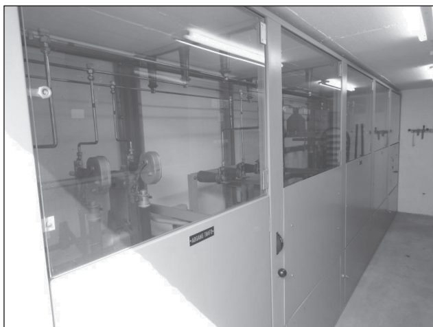
Die Mess- und Trafostation Hohenalber aus dem Jahr 1970 muss saniert werden.
