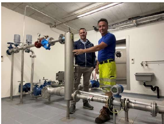
Bildlegende: Marco Jurt von der Wasserversorgung Rickenbach-Dorf und Gemeinderat Andreas Wermelinger im Reservoir Buttenberg
