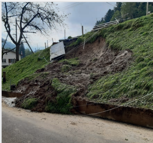
Abrutsch beim Oberdorf Werthenstein
