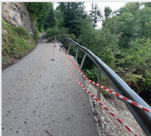
Abrutsch Strasse vor Fischenbachbrücke Schachen
