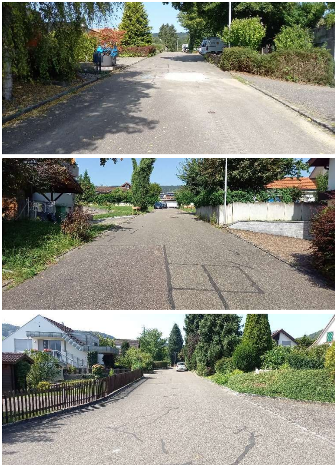
Abbildung 1 Strassenzustand des Leimenwegs
