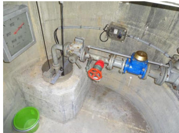
Abb. 4.6: Filterbrunnen III mit Pumpe
