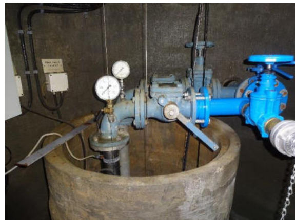
Abb. 4.2: Filterbrunnen I mit Pumpen
