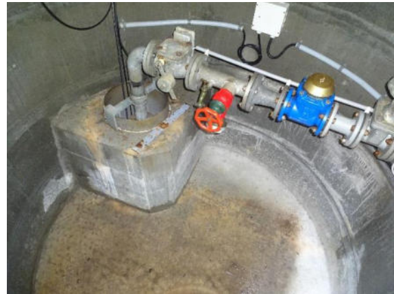
Abb. 4.4: Filterbrunnen II mit Pumpe
