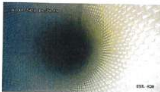
6, 00:08:11, 22.40m Stato generale, esempio foto / esempio stato tubazione
