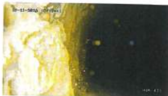
4, 00:04:01, 11.00m Grossa formazione di depositi duri nella giunzione, da ore 12 a ore 12, inizio danno
