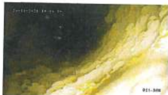
3, 00:04:01, 11.00m Grossa formazione di depositi duri nella giunzione, da ore 12 a ore 12, inizio danno
