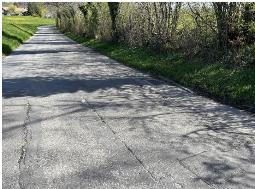
État de la chaussée
