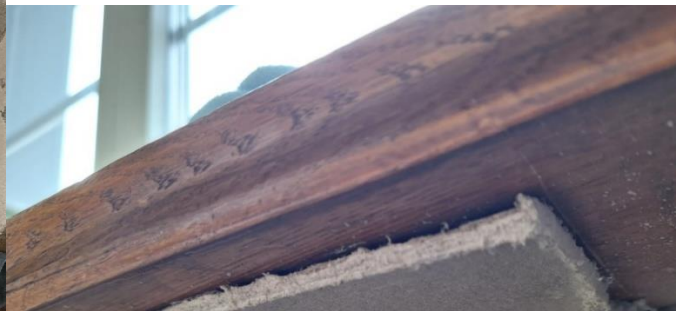
Asbest in einzelnen Räumen
