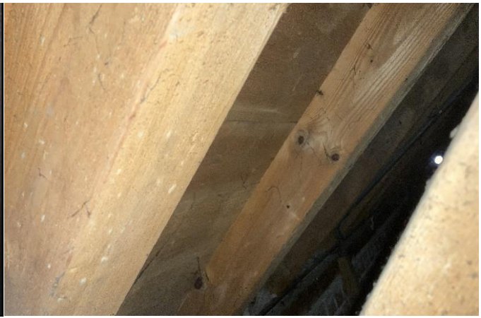
Dach teilweise ungedämmt
