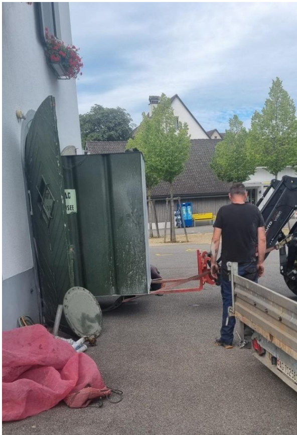
Ölheizung entfernt (s. 20 Jahren nicht mehr in Betrieb)
