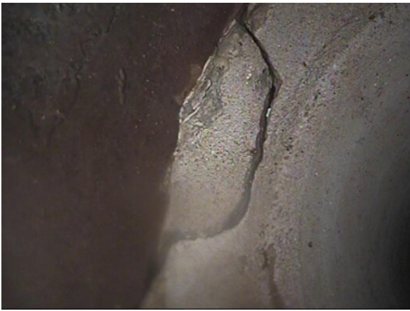
Risse im Abwasserkanal
