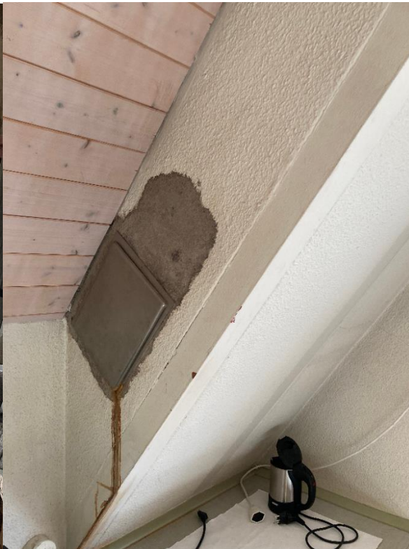
Regen dringt beim Kamin ein
