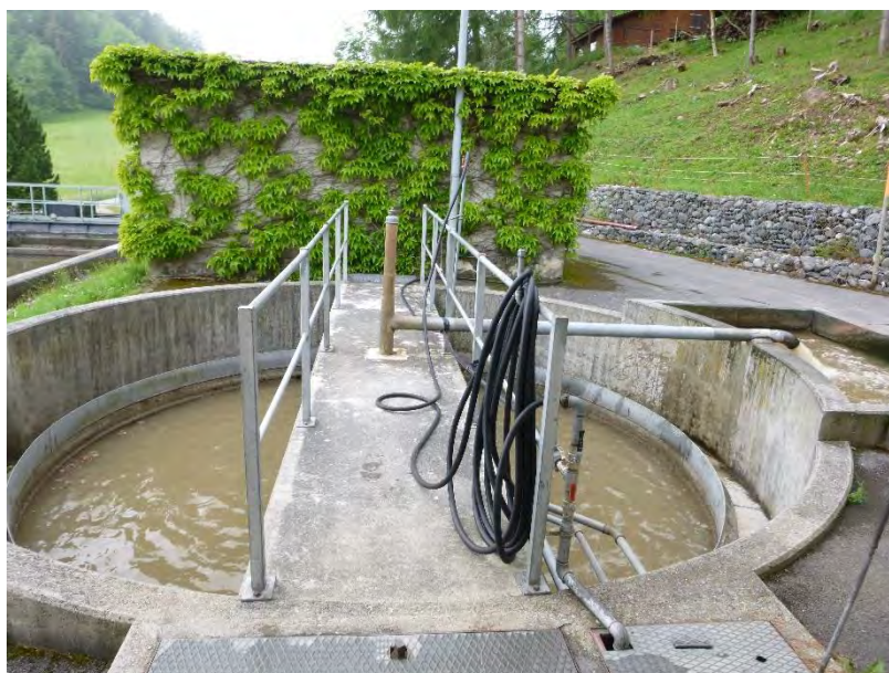
Figure 5 Photo du dessableur-déshuileur
