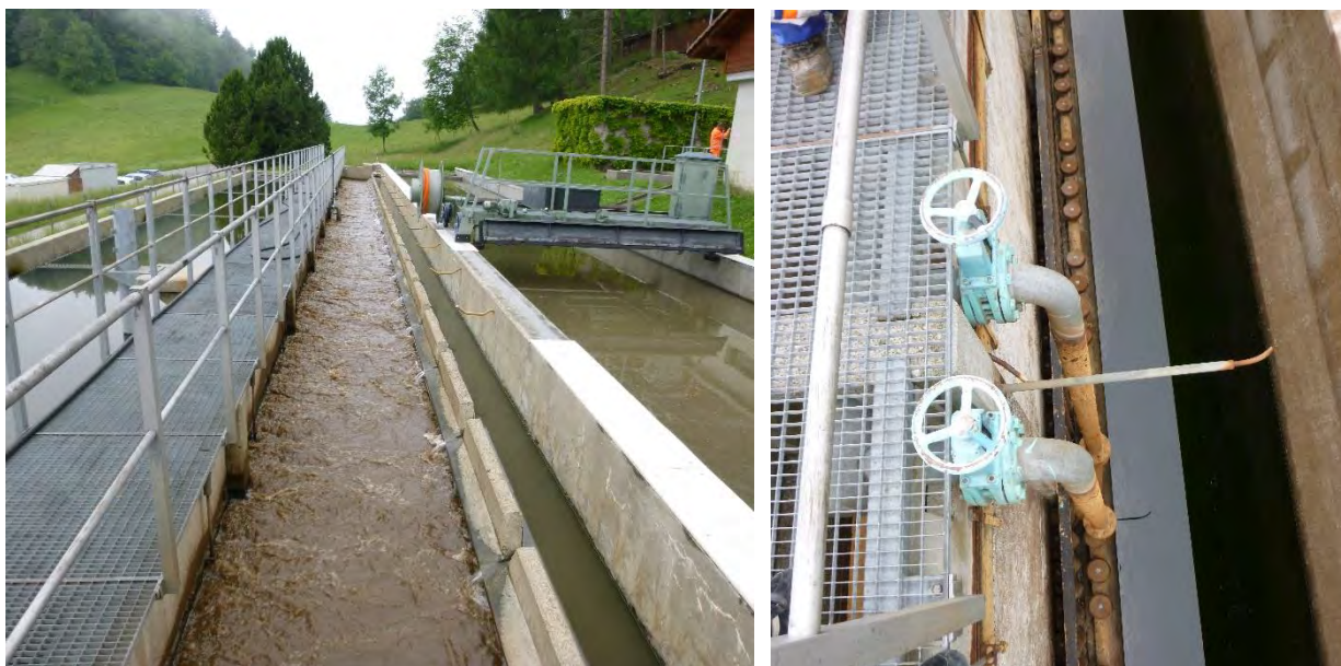
Figure 8 Photo du bassin des boues activées (à gauche) et des vannes manuelles de régulation de l'aération ainsi que du tuyau d'injection de \text{FeCl}_3 (à droite)
