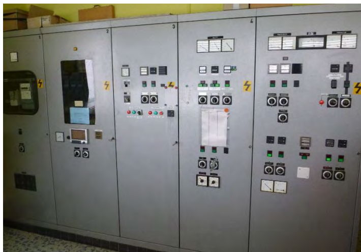
Figure 12 Photo de l'armoire électrique et de commandes de la STEP
