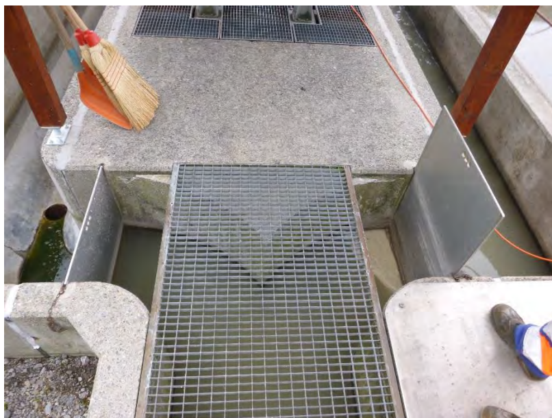
Figure 6 Photo du système de répartition des eaux entre les deux lignes, à l'aide de deux batardeaux
