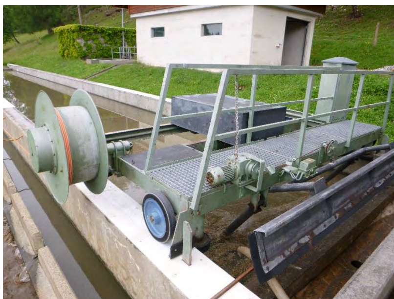
Figure 7 Photo du pont roulant
