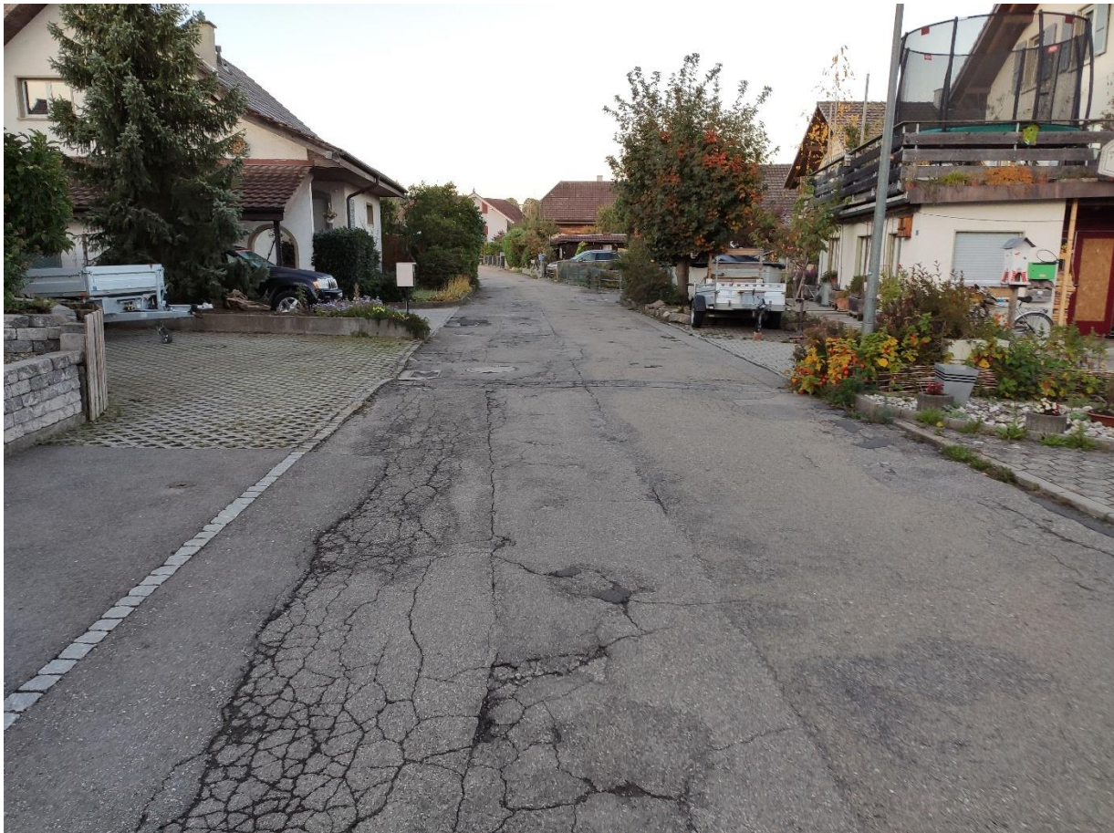
Abbildung 3: Belagsschäden im Pöschenweg.
