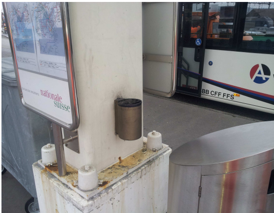
Schadstellen an der Stahlkonstruktion (Verbindung Fundament/Stahlkonstruktion)
