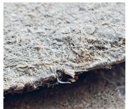
Asbest kann Krebs auslösen. Deshalb ist dringende Vorsicht beim Umgang mit diesem gefährlichen Material geboten. Bild: suva
