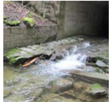
■ Der Auslauf ist sanierungsbedürftig.
