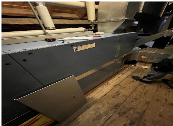
Les deux monoblocs existants
