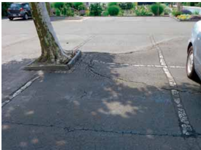
Massive Belagsschäden auf dem Aussenparkplatz des Oberstufenzentrums Flös.
