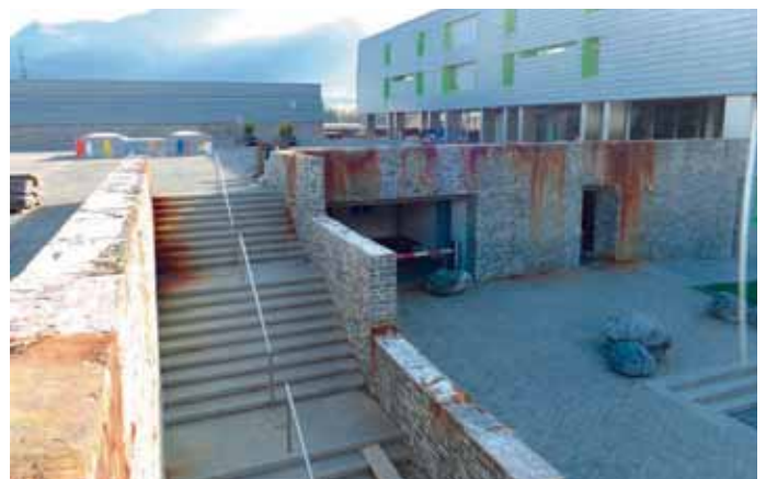
Während der Rückbauarbeiten sind die Verfärbungen an der Fassade noch deutlich sichtbar.
