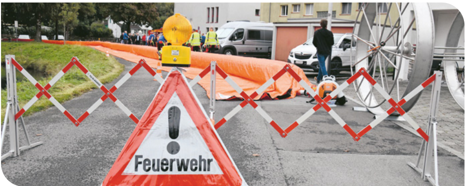
Das mobile Hochwasserschutzsystem in Aktion
