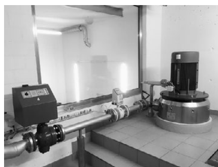
Turbine (rechts) des Trinkwasserkraftwerkes im Reservoir Rütli
