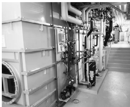
Neuer Technikraum der Schwimmhalle
