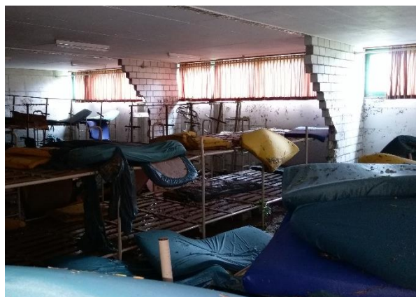
In der Militärunterkunft drückte das Wasser tragende Mauern ein
