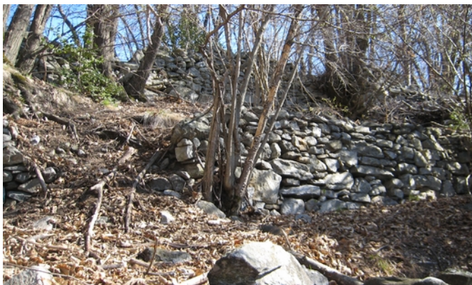
Fig. 5 Terrazzamenti alberati. Tratta di muro a secco crollato. Potenziale causa di inizio di franamento.
