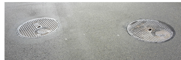
Regen- und Schmutzabwasserkanalisation können anhand des Schachtdeckels nicht unterschieden werden.
