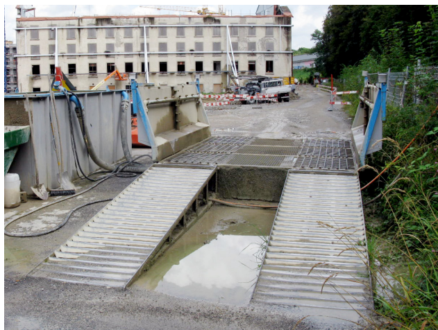
Beim Waschplatz muss das Wasser aufgefangen werden.
