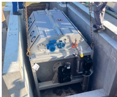
Trommelsiebe zur maschinellen Vorklärung.
