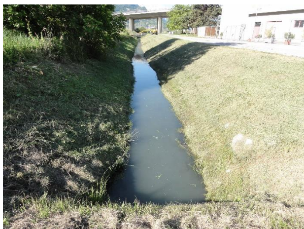
Photo 1 : Canal du Syndicat. Entretien destructif des berges. (2°58'2768 ; 1°11'3'346)
