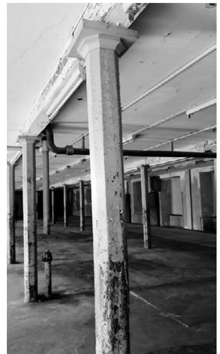
Schadhafte Bausubstanz Spinnerei Uznach
