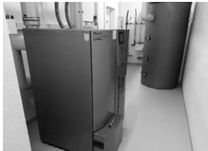
Heizraum mit Pellet-Heizkessel
