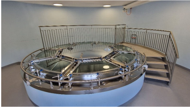
Abbildung 9: Foto GWF Oberi Au, Uttigen Beispiel Brunnenabdeckung
