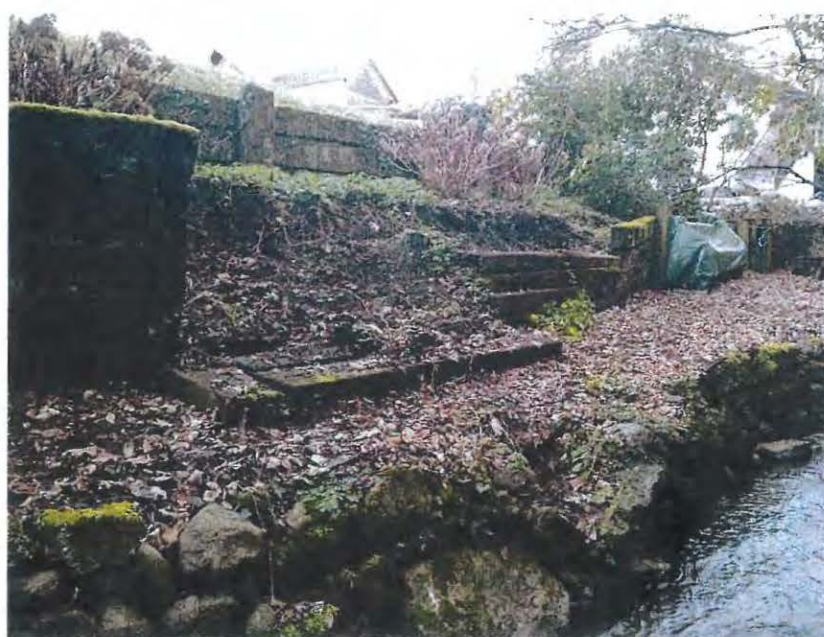
Photo 4 – Planches en bois effondrées (parcelle n° 724)
