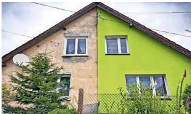
Symbolfoto eines Gebäudes, wie die Fassade nach einer Sanierung eben nicht aussehen sollte...
