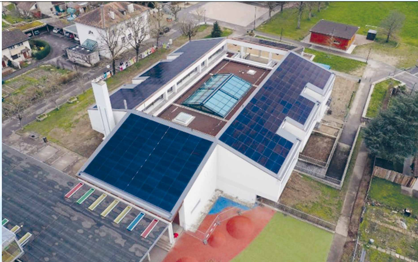
364 panneaux photovoltaïques couvrent l'intégralité de la toiture de l'école.
