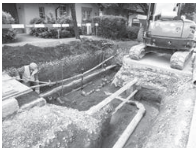
Hydrantenleitung Gasterstrasse im Bereich Spitalzufahrt
