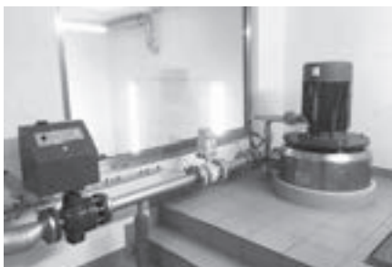
Nebst Strom vom Dach nutzt die Gemeinde seit 2018 auch die Energie des Trinkwasserkraftwerkes Rüti (Turbine im Hintergrund)
