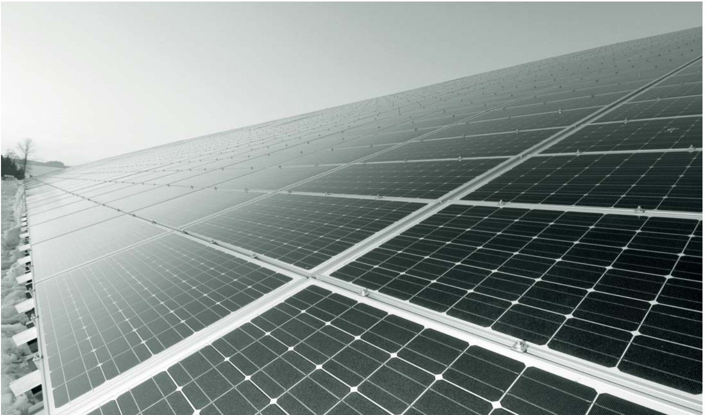
Beispiel einer Photovoltaik-Anlage.
