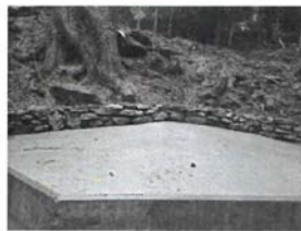
Quellfassung mit Böschungsabschluss
