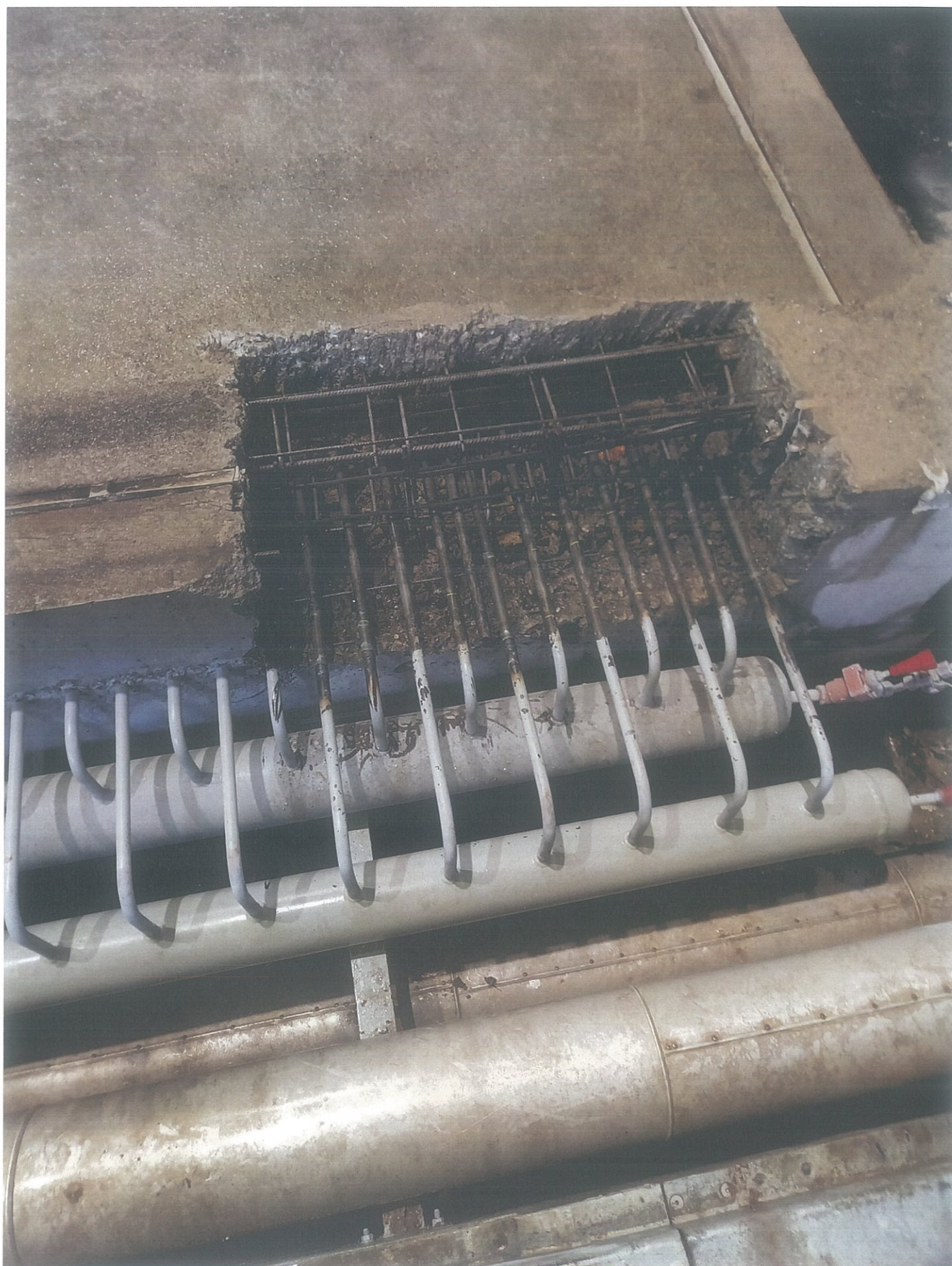
Impianto di distribuzione del freddo – Dettaglio introduzione delle serpentine nella piastra
